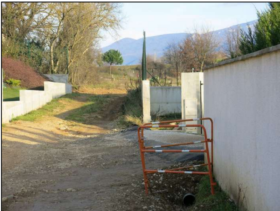
Figure 9: Bourrelet d'enrobé au droit du portail de la parcelle 407.
